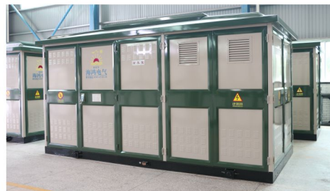
深圳20kV欧变项目
