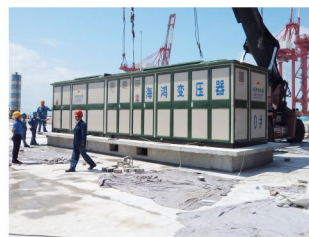
赤湾码头智能箱变项目
